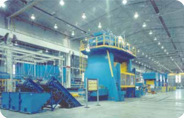
Fabrika Uygulaması: Seri Yakıclı Sistem - Genel Isıtma
